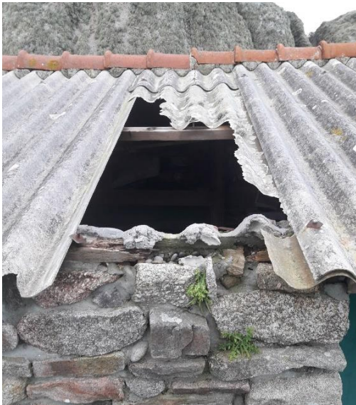
Brèche dans la toiture de la cabane de Balaneg © David Bourles / OFB
